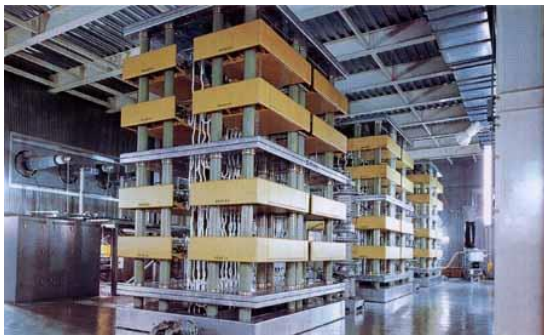
サイリスタ周波数変換設備
