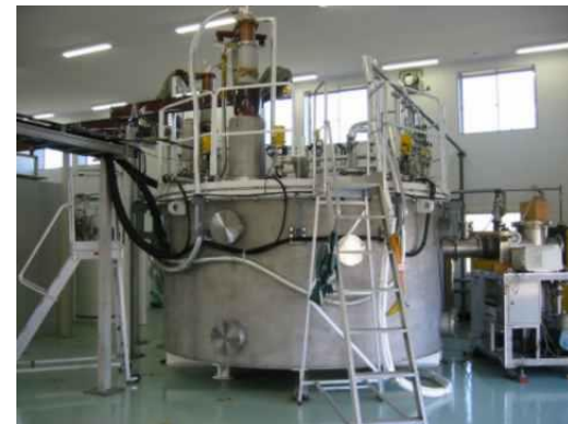
SMES(超伝導磁気エネルギー貯蔵装置)
